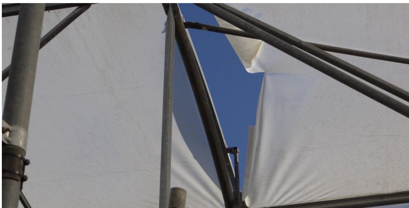
Imagen 9: Degradación de la cubierta plástica al utilizar sublimadores sin protección
